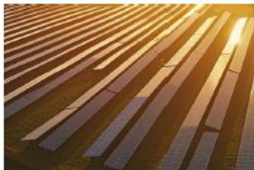
Instalación Solar Grande
